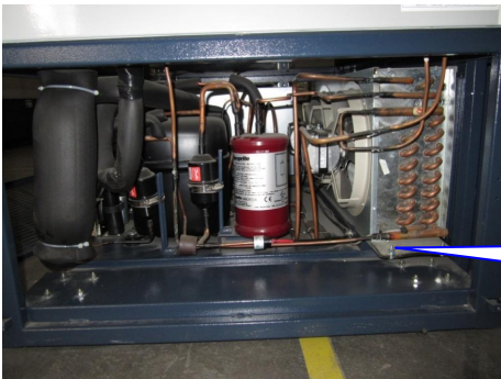
Condenser sensor E1
